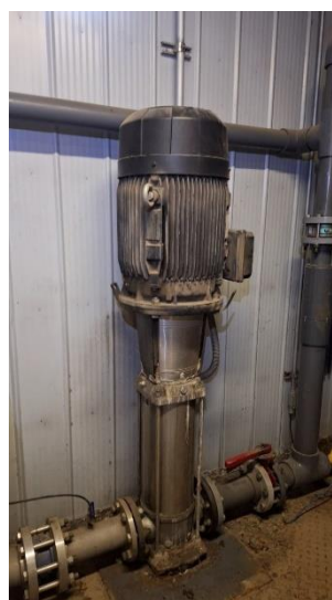
Figura 4. Bomba Multietapa vertical de alta presión en PMTOI. Fuente: Confidencial.
