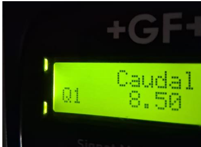
Figura 9. Registro display caudal de rechazo OI. Fuente: Confidencial.
