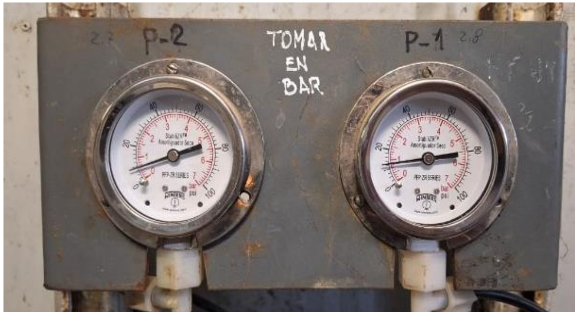
Figura 16. Diferencial de presión incorrecta por no purga de aire de porta cartuchos generados por mala instalación. Fuente: Confidencial.
