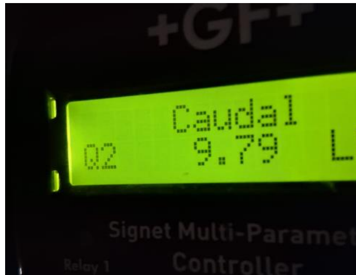
Figura 10. Registro display caudal de permeado OI. Fuente: Confidencial.
