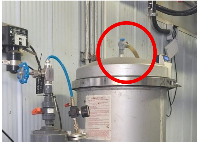
Figura 17. Sistema de purga de aire cerrada por no verificación. Fuente: Confidencial.
